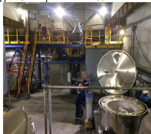
Рис.2. Фото установки УРВ9
